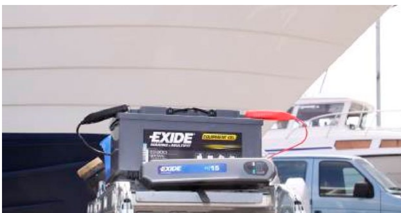
Det er viktig å kontrollere at batteriet er fulladet.
