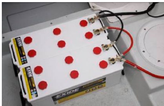
Eksempel på en batteribank for forbruksbatterier i en båt. Her 1900Wh.
